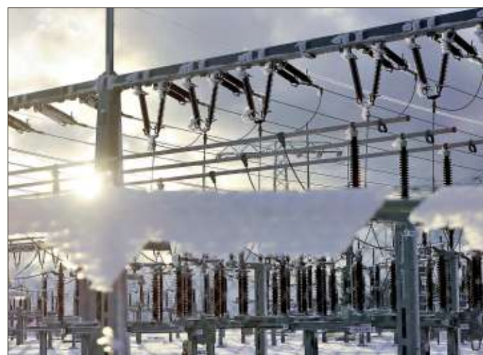
Das Umspannwerk in Hüttenrode - am späten Sonntagabend kam es hier zu einer gerissenen Stromleitung. Die Folge war ein großflächiger Stromausfall im Landkreis Harz. Foto: Matthias Bein
